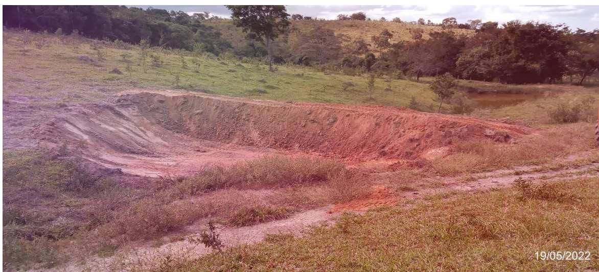
Figura 4.4 – Bacia de contenção
